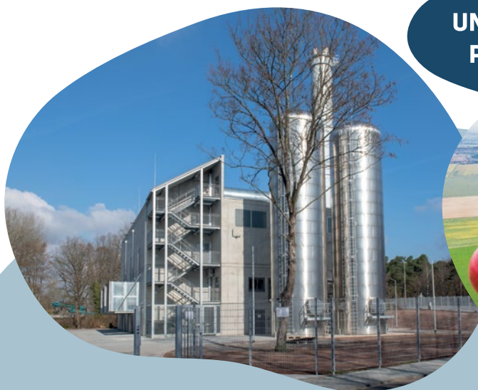
BHKW in Ramstein-Miesenbach
