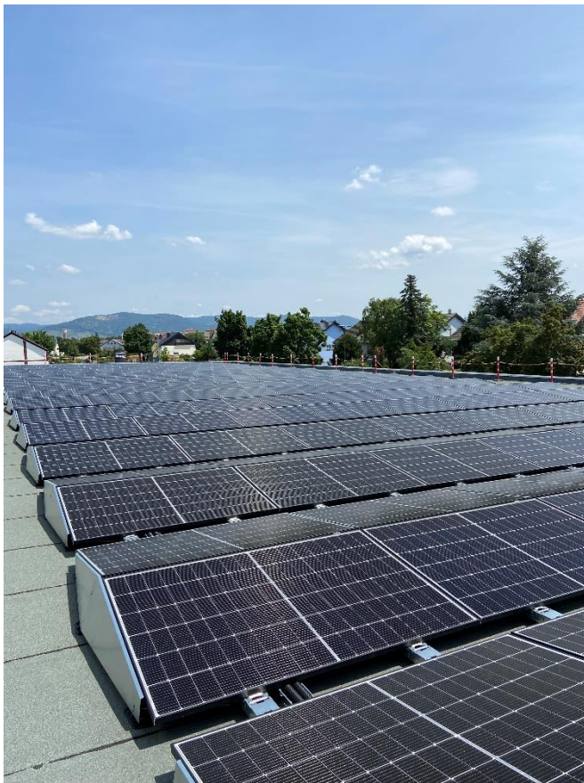
PV-Anlage auf dem Hallendach von BÄKO Süd-West eG. Bildquelle: Pfalzwerke
