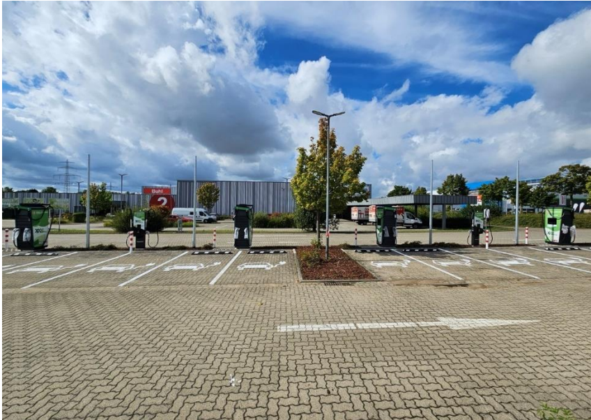
Die Schnellladesäulen sind betriebsbereit.
